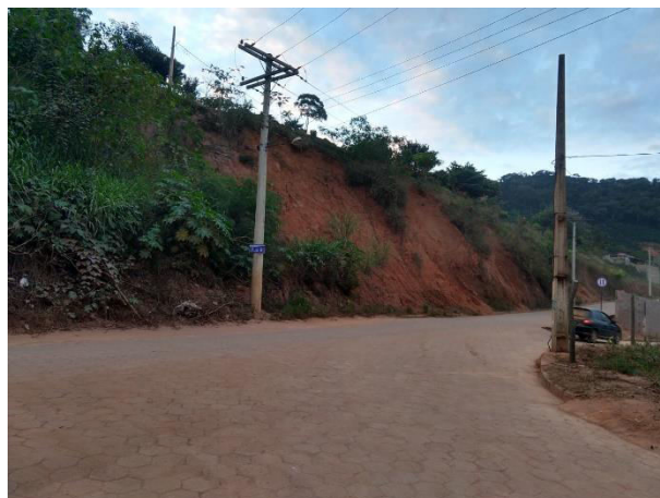
Figura 10: Vista de talude em acesso ao distrito. Localização no acesso próximo ao ribeirão 2. Data das imagens: 14/06/2021
