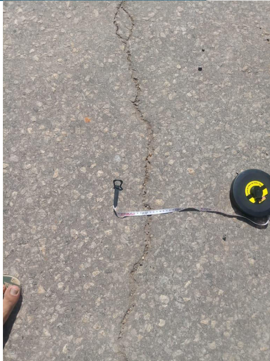
Figura 3: Trincas longitudinais. Fonte: Elaborado pelos pesquisadores (2019)
