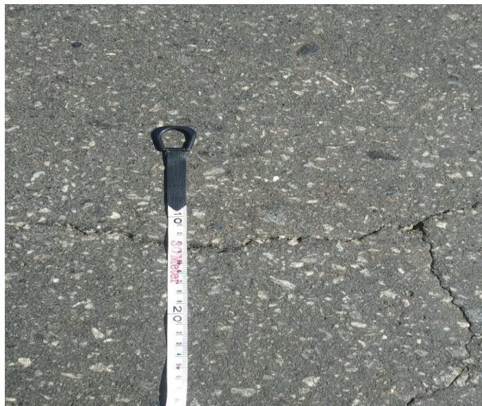
Figura 4: Trincas interligadas ou couro de jacaré Fonte: Elaborado pelos pesquisadores (2019)
