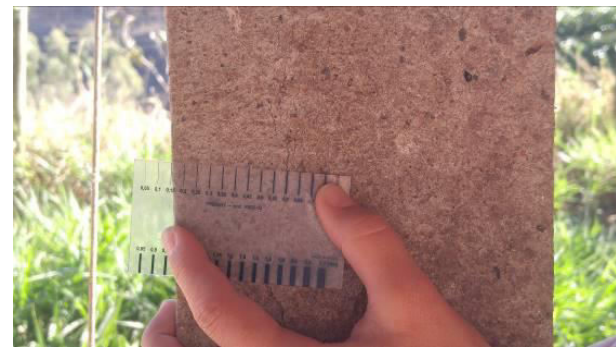
Figura 2: Incidência de trinca em um dos pilares observados. Fonte: Os Autores (2019).
