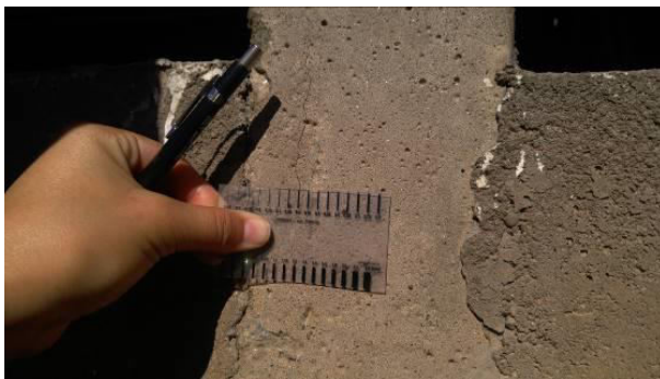
Figura 1: Incidência de fissura em um dos pilares observados. Fonte: Os Autores (2019).
