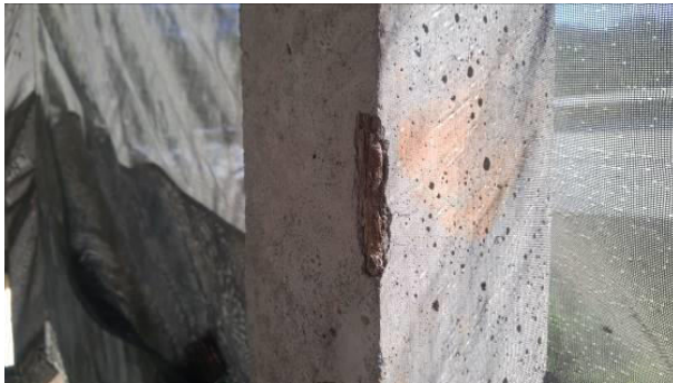
Figura 4: Pilar com ocorrência de bolhas superficiais. Fonte: Os Autores (2019).
