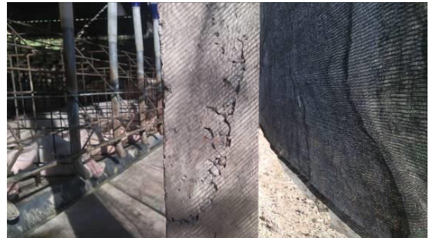
Figura 5: Ninho de concretagem observado em um dos pilares observados. Fonte: Os Autores (2019).
