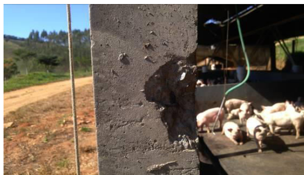
Figura 3: Fragmentação de porção do concreto em um dos pilares observados. Fonte: Os Autores (2019).
